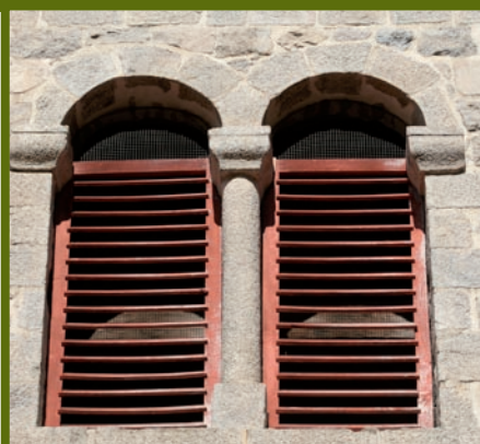
Abats-sons grillagés d'une église. L'espace entre les persiennes semble assez petit pour éviter le passage de pigeons. La suppression simple du grillage contribuerait à améliorer le passage des chauves-souris.
