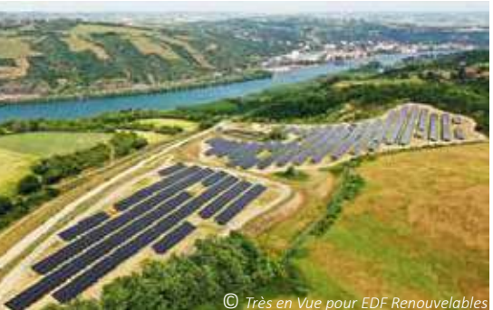
Centrale photovoltaïque au sol réalisée sur une ancienne décharge à Saint-Romain en Gal.
